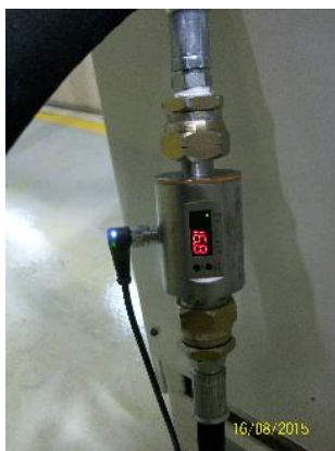
FIGURA 37: MEDIDOR DE VAZÃO INSTALADO NA SAÍDA DO EQUIPAMENTO.
