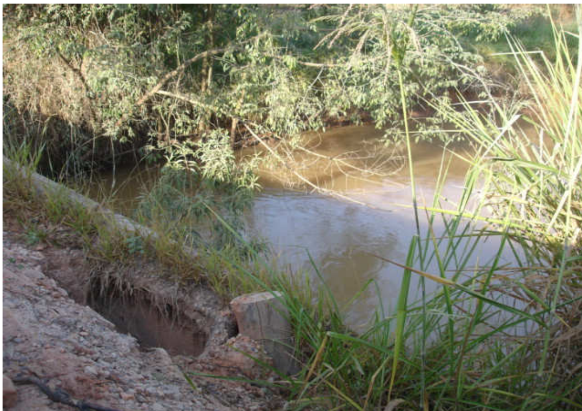
Figura 4 – Ponte existente que foi danificada e caiu parcialmente não podendo mais ser utilizada
