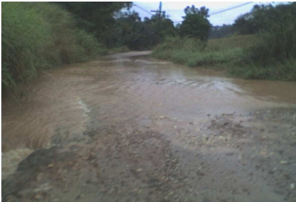
Figura 7 – Imagem tirada em 10/08/08 onde se comprova a interdição total da estrada sem o tráfego de veículos e pessoas
