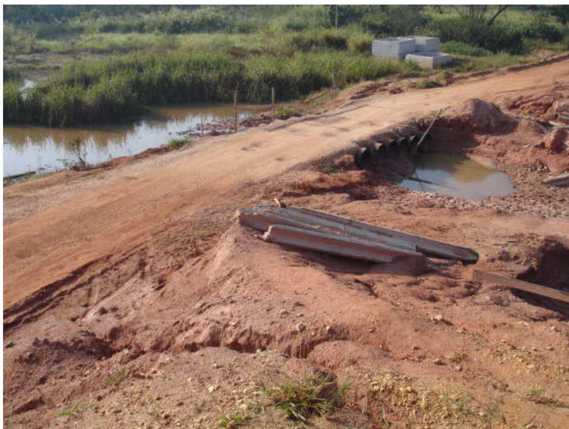
Figura 3 – Preparação de acesso provisório para tráfego de veículos e pessoas com emprego de materiais, mão de obra e equipamentos.
