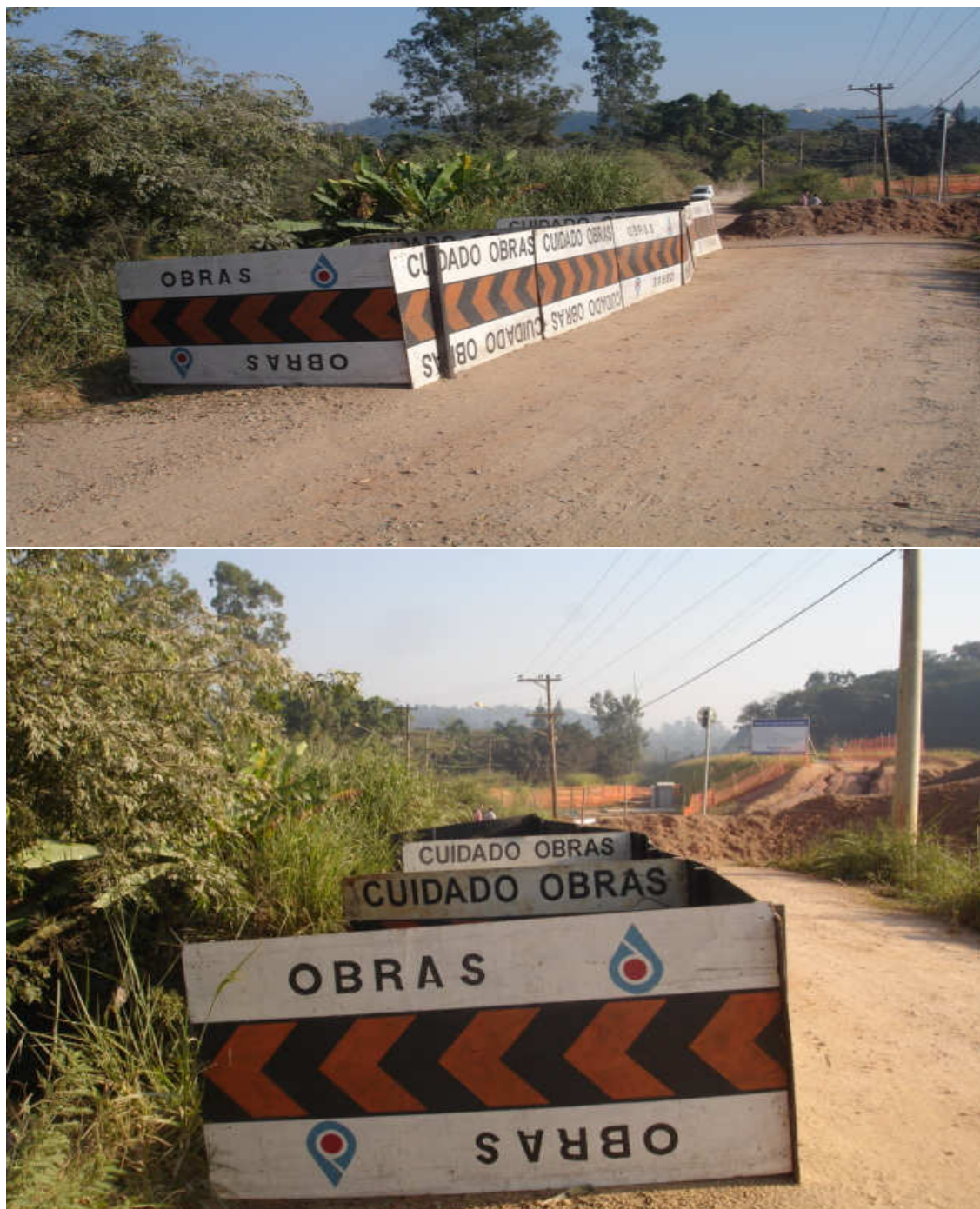
Figura 2 – Sinalização viária para a prevenção de acidentes.
