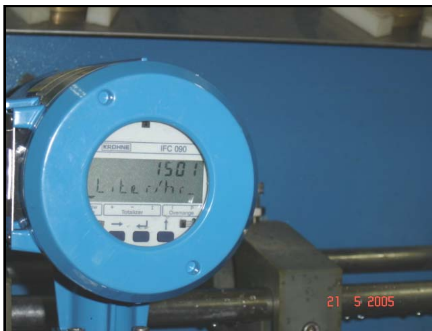
Figura 27 – Medidor de vazão eletromagnético, indicando vazão instantânea.
