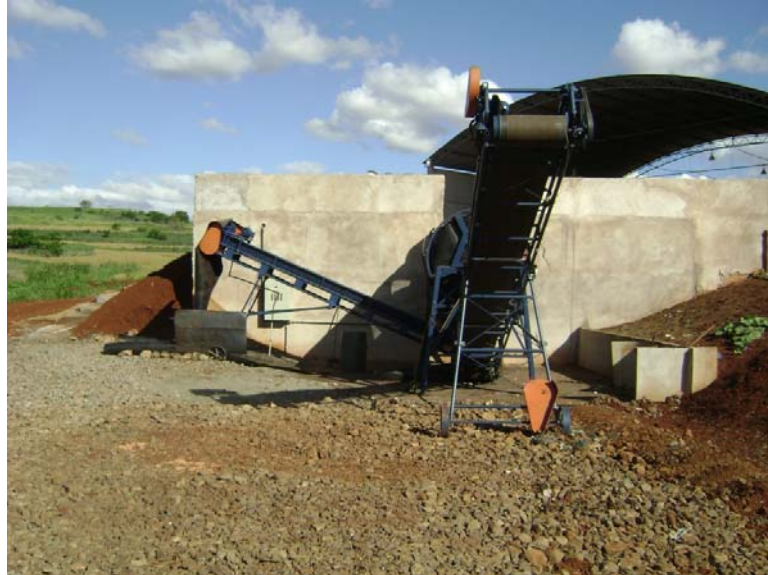
Figura 15 - Usina de triagem, CTR, Londrina, 2010
