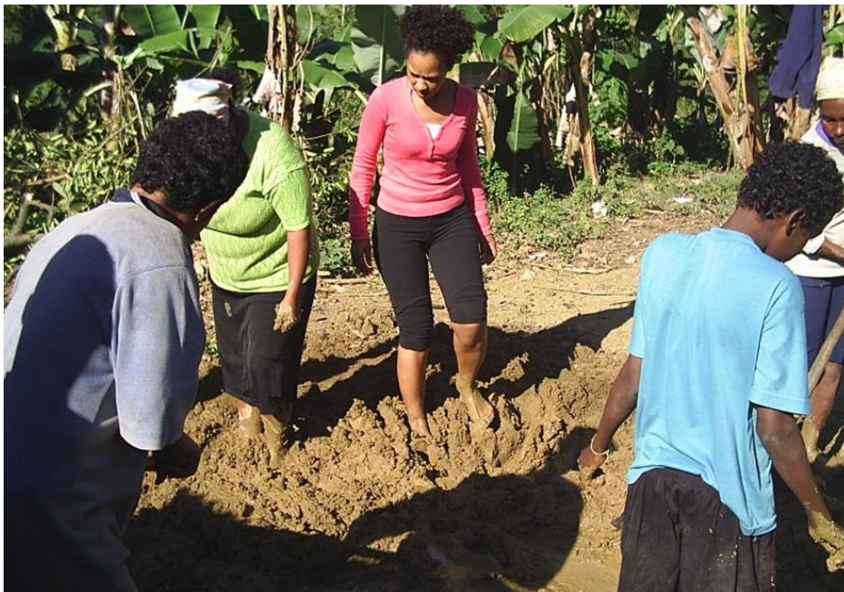
Figura 11 – Construção coletiva da casa de pau-a-pique de Maria Furquim – no Bocó – Quilombo Ivaporunduva -
