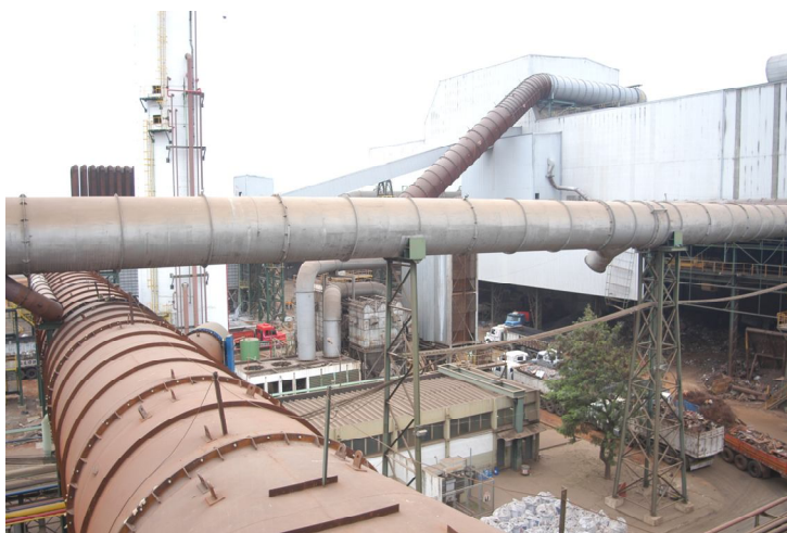
Figura 9 - Vista do sistema de despoejamento do forno elétrico Fonte: Sid SI, 2004
