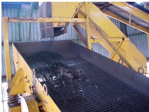
Figura 40 - Vista das peneiras vibratórias Fonte: Bugue Reciclagem
