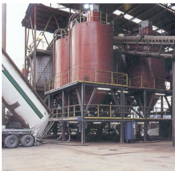
Silos pneumáticos de armazenamento
