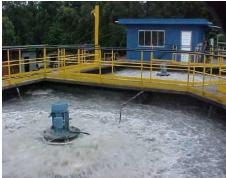
Figura 08: Tanque de Aeração. Fonte: Empresa: 2007.
