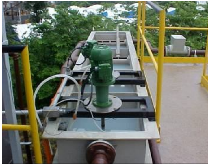
Figura 7: Tanque de Coagulação e Decantação. Fonte: Empresa, 2007
