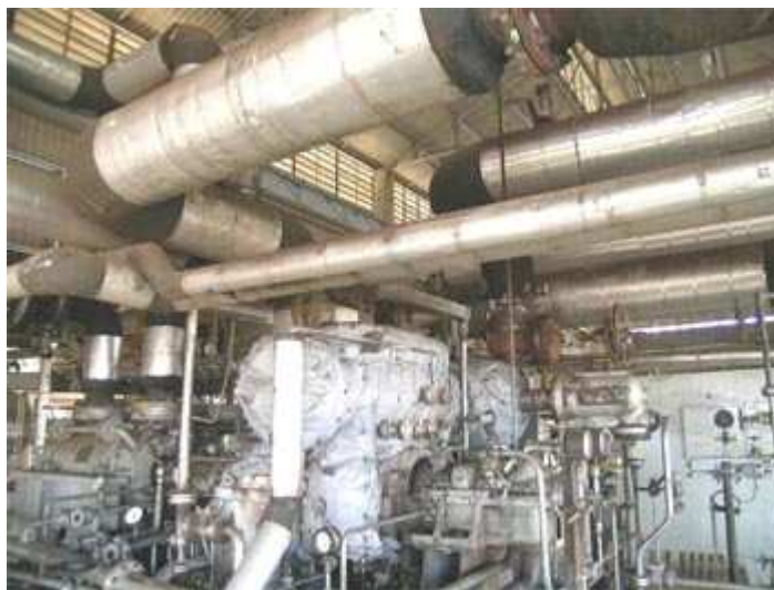
Figura 8: Tubulações dificultando acesso à máquina (NOBREGA, 2005)
