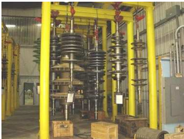
Figura 23. Rotor armazenado em armazém climatizado (NOBREGA, 2005)
